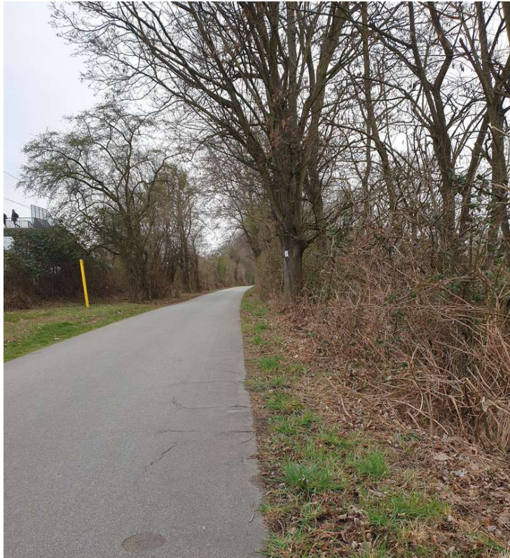
Abb: Baumbestand nördl. (hier: rechts) des Neckartalradwegs auf Höhe Haltepunkt Duale Hochschule mit Wurzelwerk unter dem Asphalt, der den Asphalt aufwölbt
