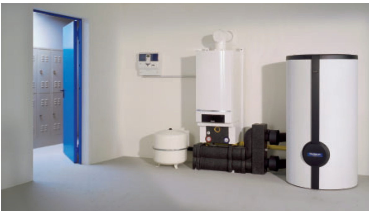
Moderne Heizkessel helfen Energie zu sparen
